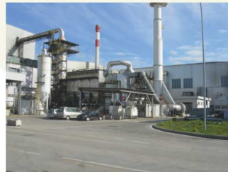
Panoramica della sezione trattamento fumi
