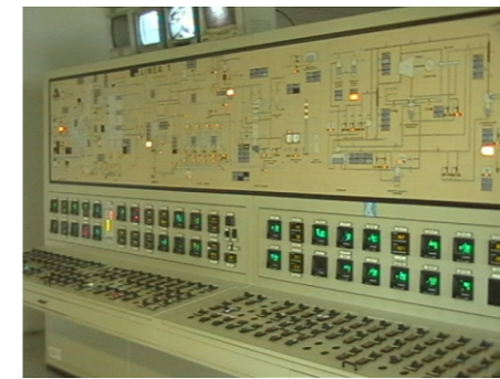
Sala di controllo generale
